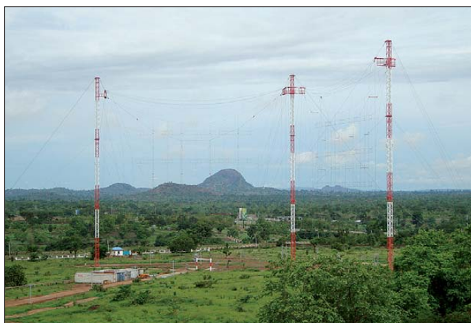
Die Vorhangantenne der Voice Of Nigeria in Nord und West
