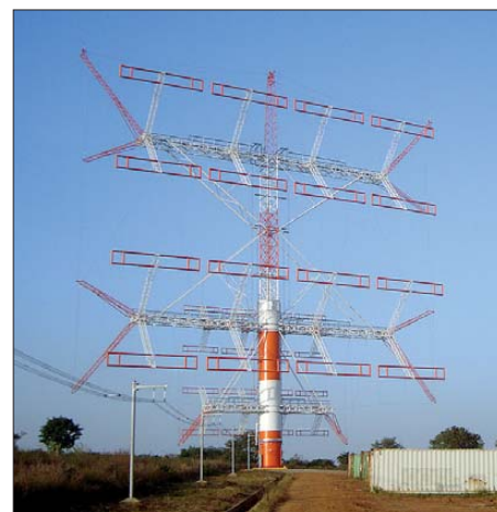
Blick auf die drehbare Antennenanlage
