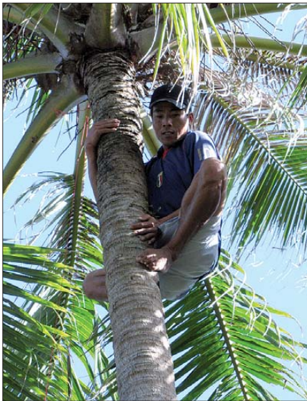
Hotelgärtner bei der Installation eines Dipols; er hat die Palme ohne Hilfsmittel erklettert.
